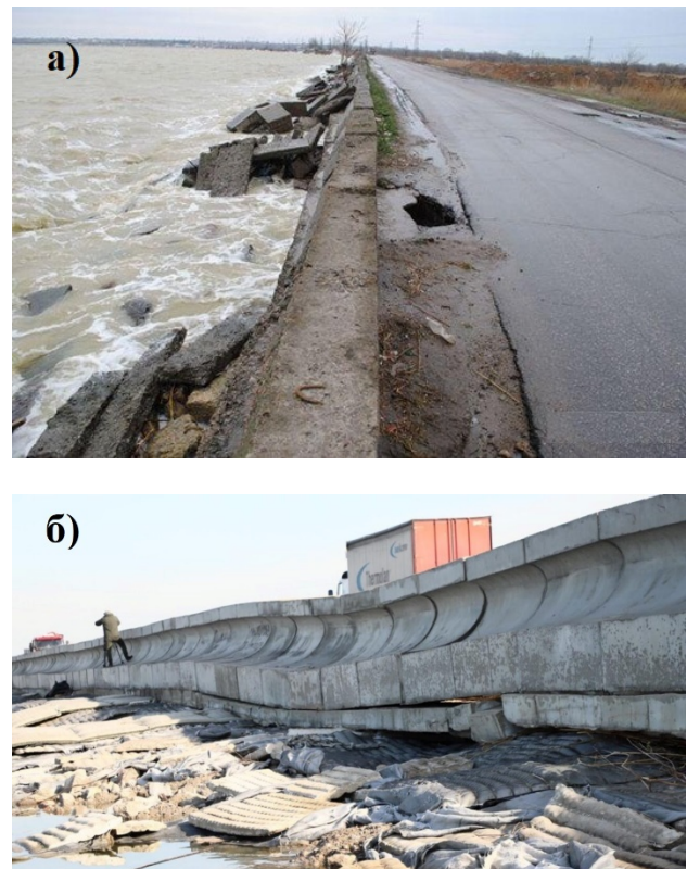
Рис. 3 – Розмив дамби Хаджибейського лиману Fig. 3 – Washout of the Khadzhybeyskiy Estuary's bund
